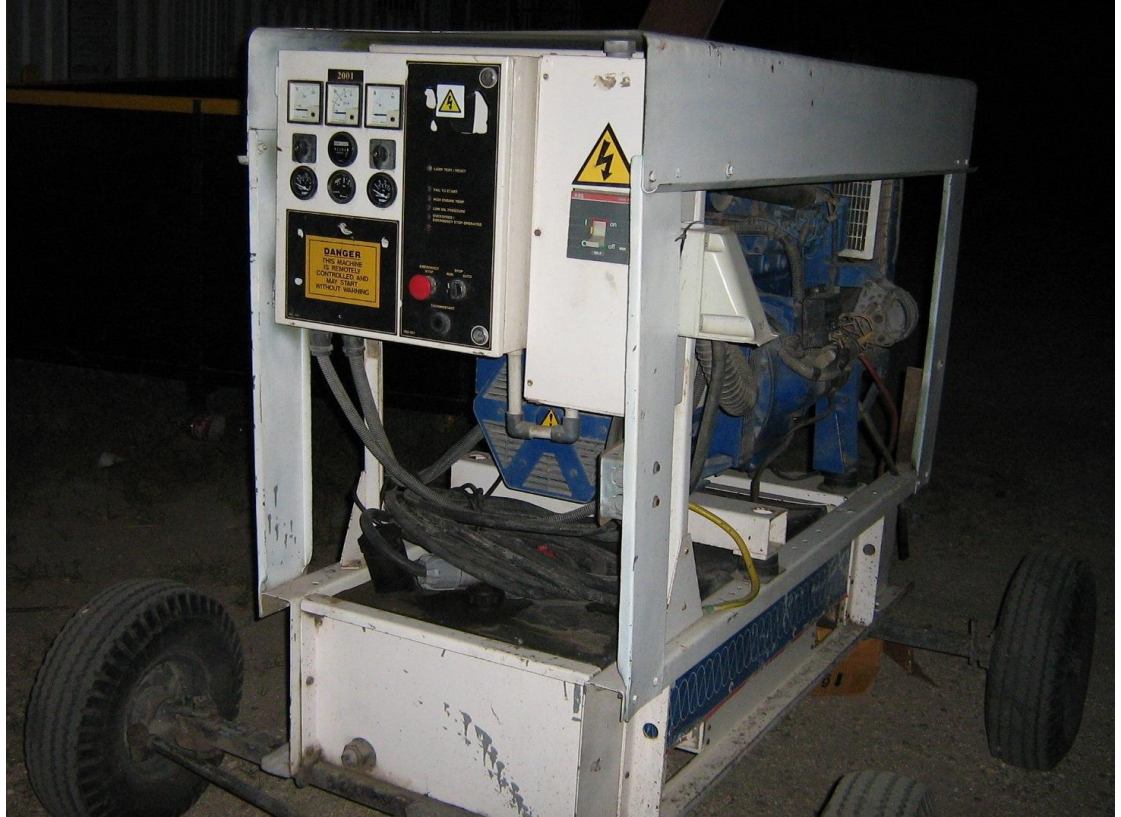
Anexo 7. Planta eléctrica FG Wilson PJ30, 23 KW, cod. GE0201, foto 2
