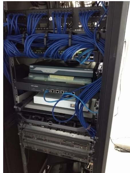
Dispositivos del Rack.
