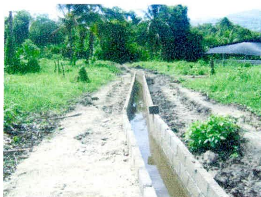
Figura 4. Canal auxiliar de laguna de oxidación
