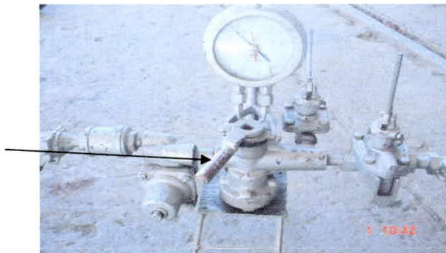
Foto 115. Llave principal en posición de recubrimiento
