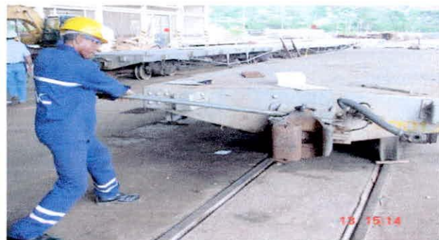
Foto 91. Barra como palanca que facilite la caída o salida del enganche
