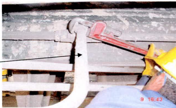
Foto 168. Tubo que alimenta al colector de polvo
