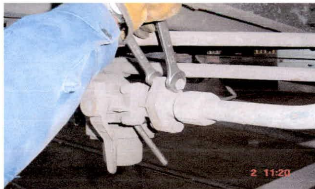
Foto 138. Afloje de tornillos de la brida de entrada de aire de la tubería
