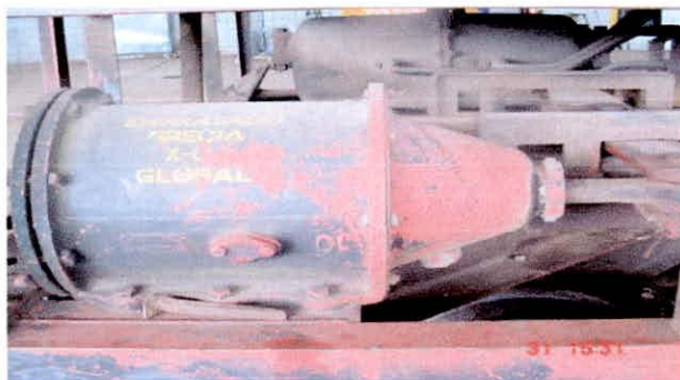
Foto 111. Unidad del sistema de aire
