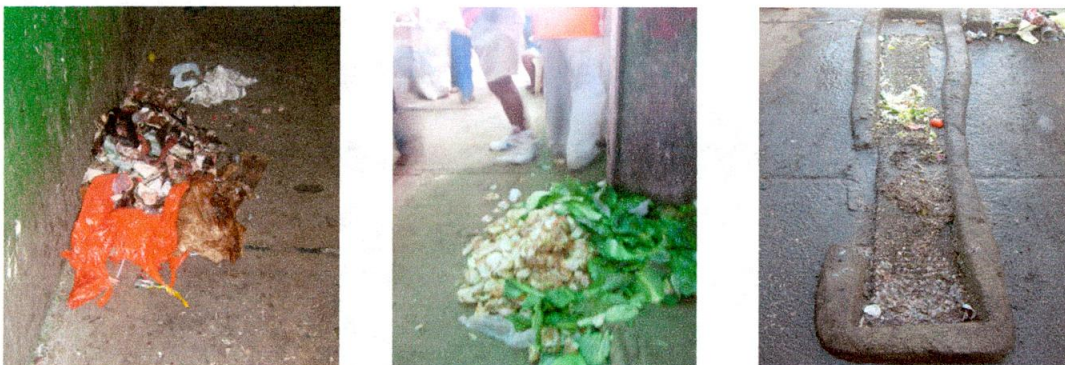
Figura 7: Obstrucción de los pasillos y drenajes por residuos, en las zona 1 y 3 de la sección de alimentos perecederos de la plaza de mercado El Pueblito
