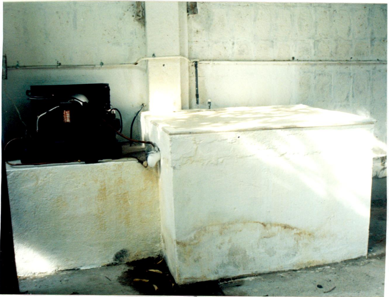
Figura 3. Vista del equipo de refrigeración y el banco de hielo.
