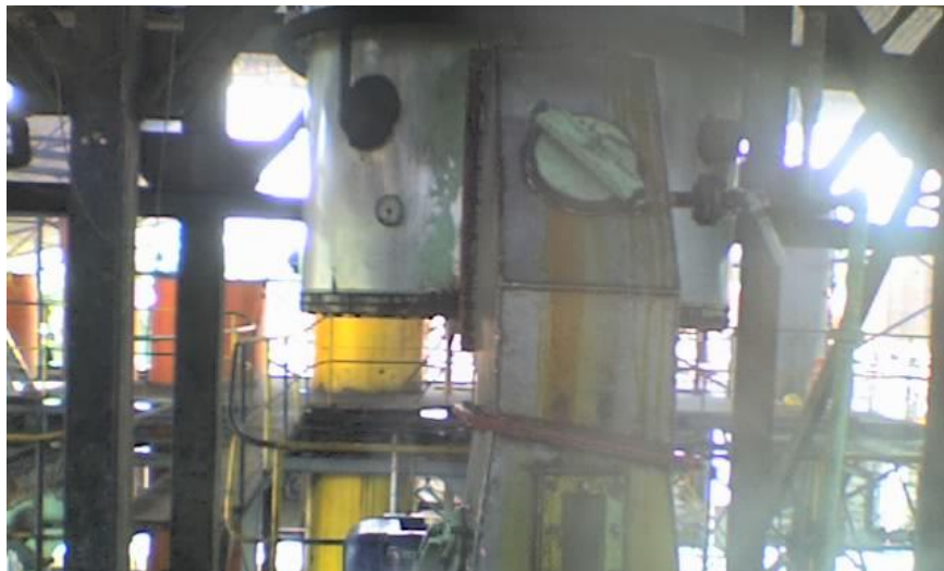
Imagen 1 Fotografía de Digestores
