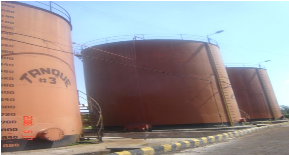
Figura 12. Tanques de Almacenamiento
