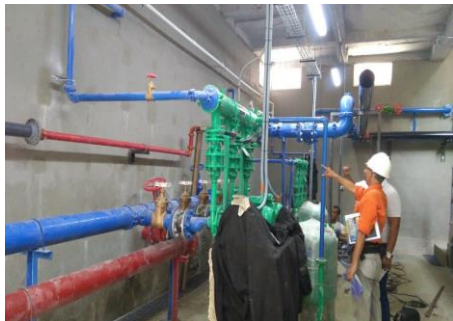
Imagen 7. Cuarto de máquinas de tanque de almacenamiento de agua
