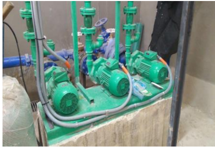
Imagen 1. Cuarto de máquinas de Tanque de almacenamiento de agua
