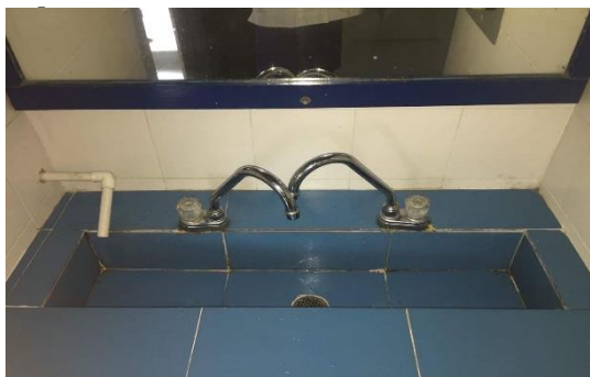
Figura 3. Lavamanos ubicados en el baño de los niños.
