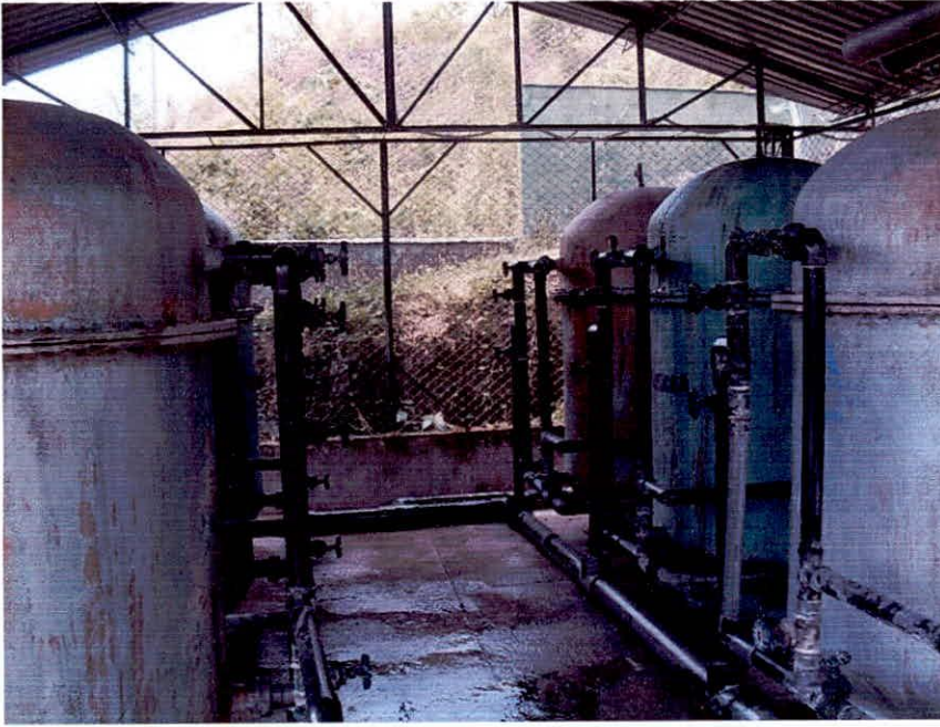
Foto 9 Bateria de filtros a presión
