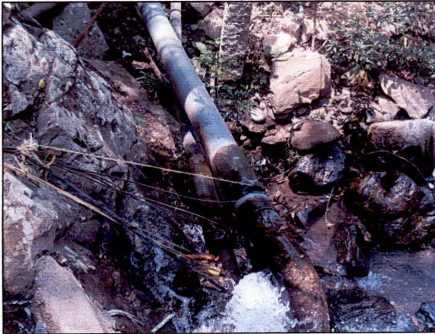
Foto 3 Tubería de aducción
