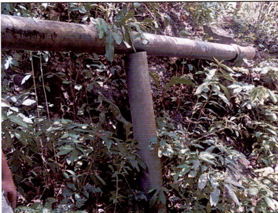
Foto 4 Soportes de la tubería de aducción
