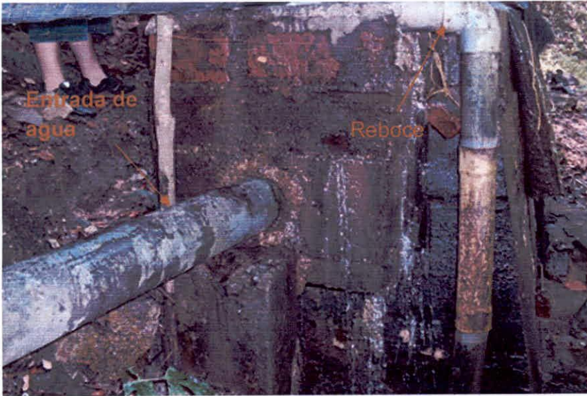
Foto 5 Entrada de agua al desarenador
