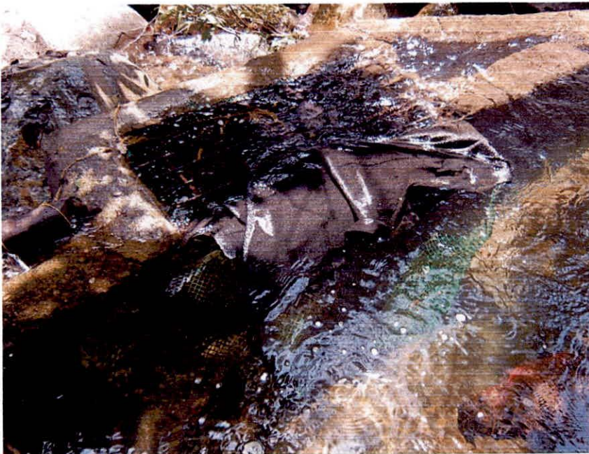
Foto 2 Rejillas retenedoras de sólidos
