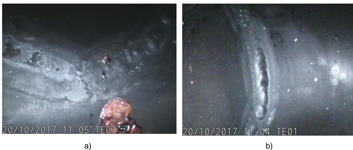
Slika 16. Segment šasije FIREWALL: stanje unutrašnje površine cijevi, detalji zavara
