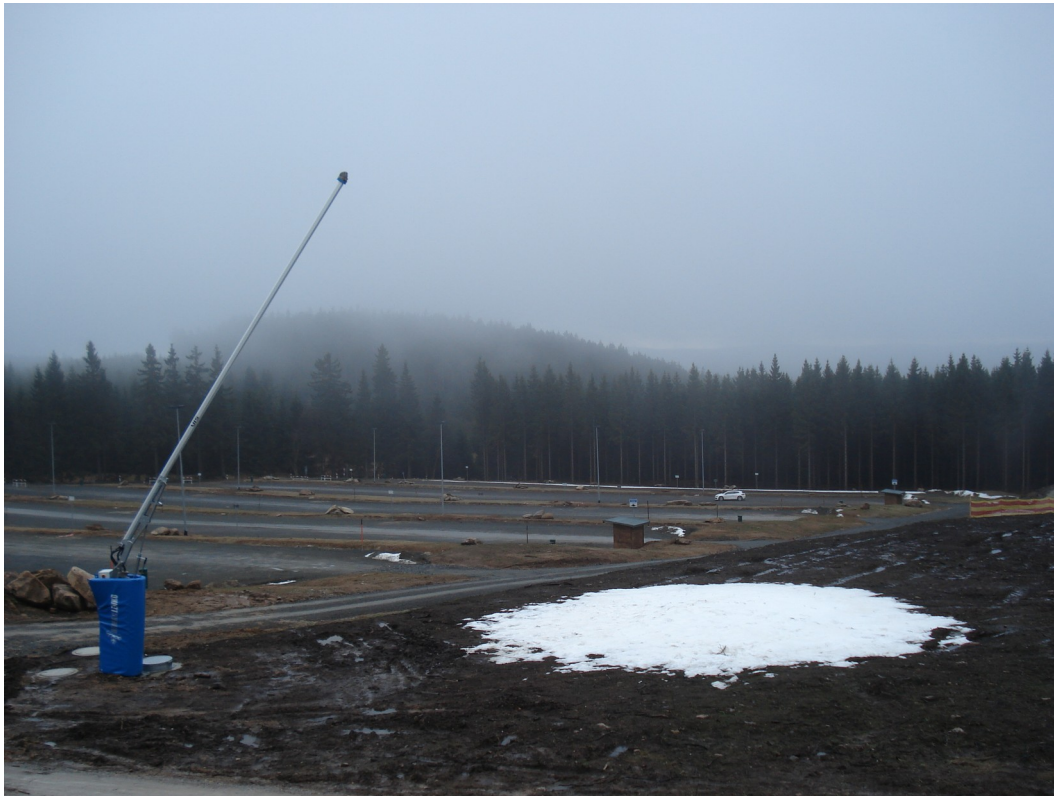
Abbildung 2: Eine Schneelanze nach einem gescheiterten Beschneiungsversuch am Hexenritt-Parkplatz in Braunlage im Oberharz.
