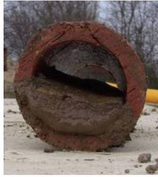
FIGUR 2-17. DRÆNRØR MED AFLEJRING AF SANDET SEDIMENT. RØRET ER FRA OPGRAVNINGEN MELLEML DRÆNSEKTION S1 OG S2.
