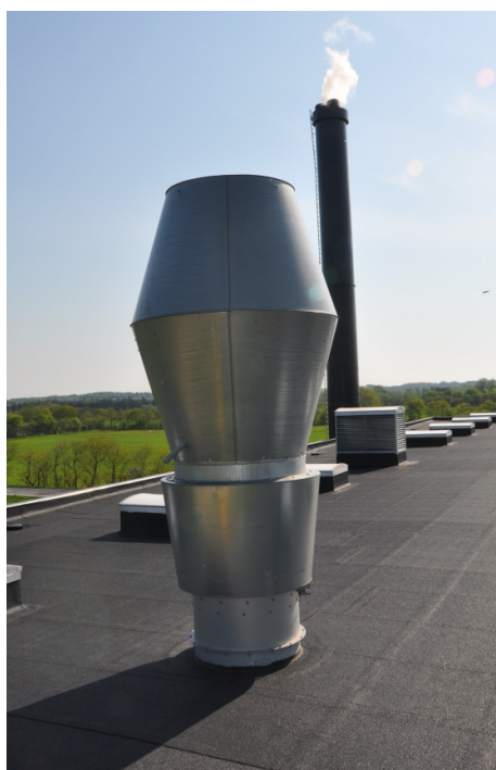
Foto: Aktiv ventilation med jet-afkast over tagniveau, ser ud til at have en god effekt på den eksterne sporespredning
