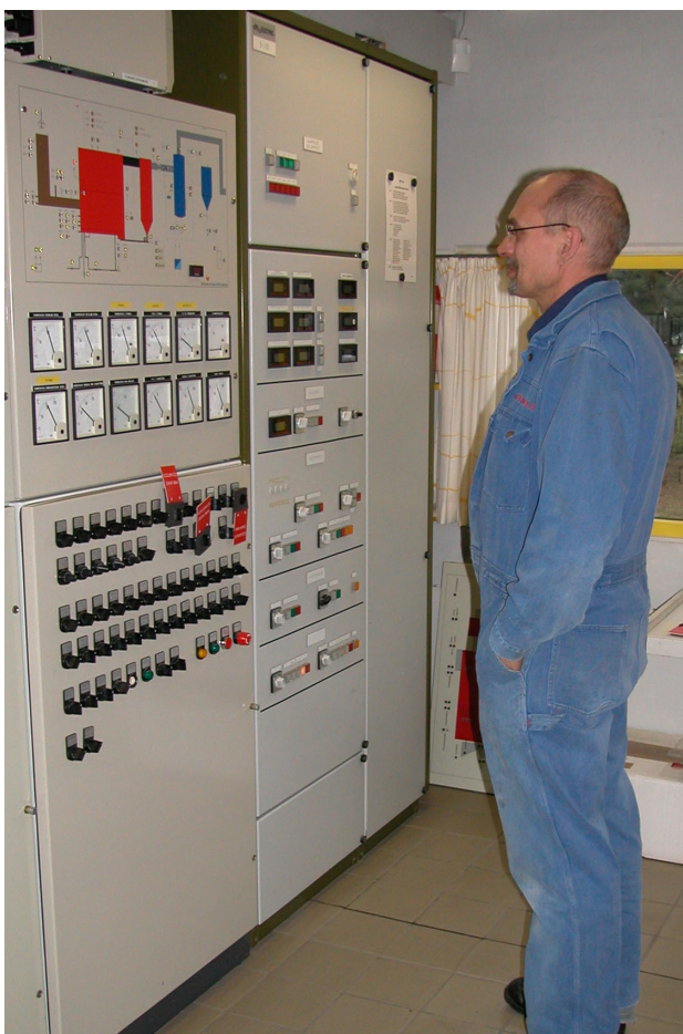
Jørgen fra Ebeltoft Varmekværk overvåger anlægget.
