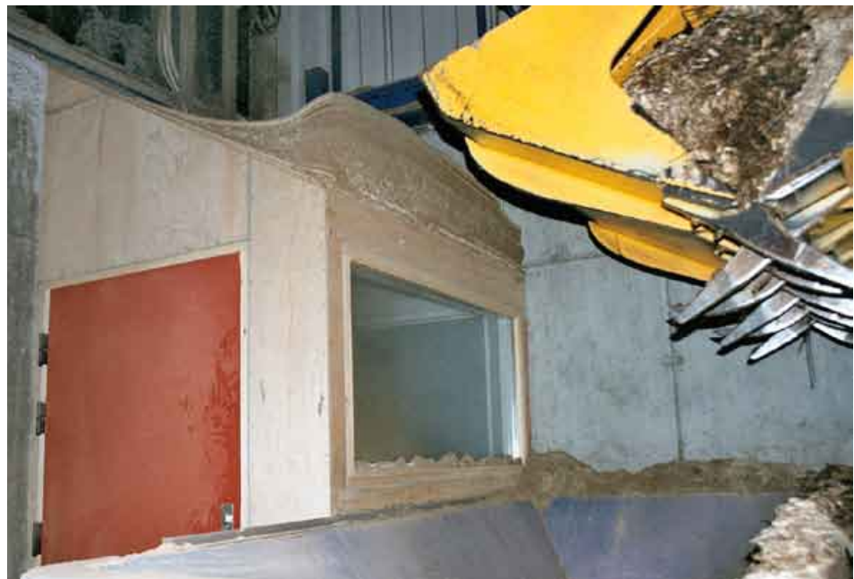
Foto 5. En sluse mellem lager og kedelhal forhindrer, at der blæser luft direkte mellem de to lokaler, når man åbner døren. Sætter man vindue i slusen, kan lageret overvåges, uden personalet eksponeres for den høje sporekoncentration i lagerluften. Effekten af en sluse kan dog ikke bevises med statistisk sikkerhed ud fra målingerne.
