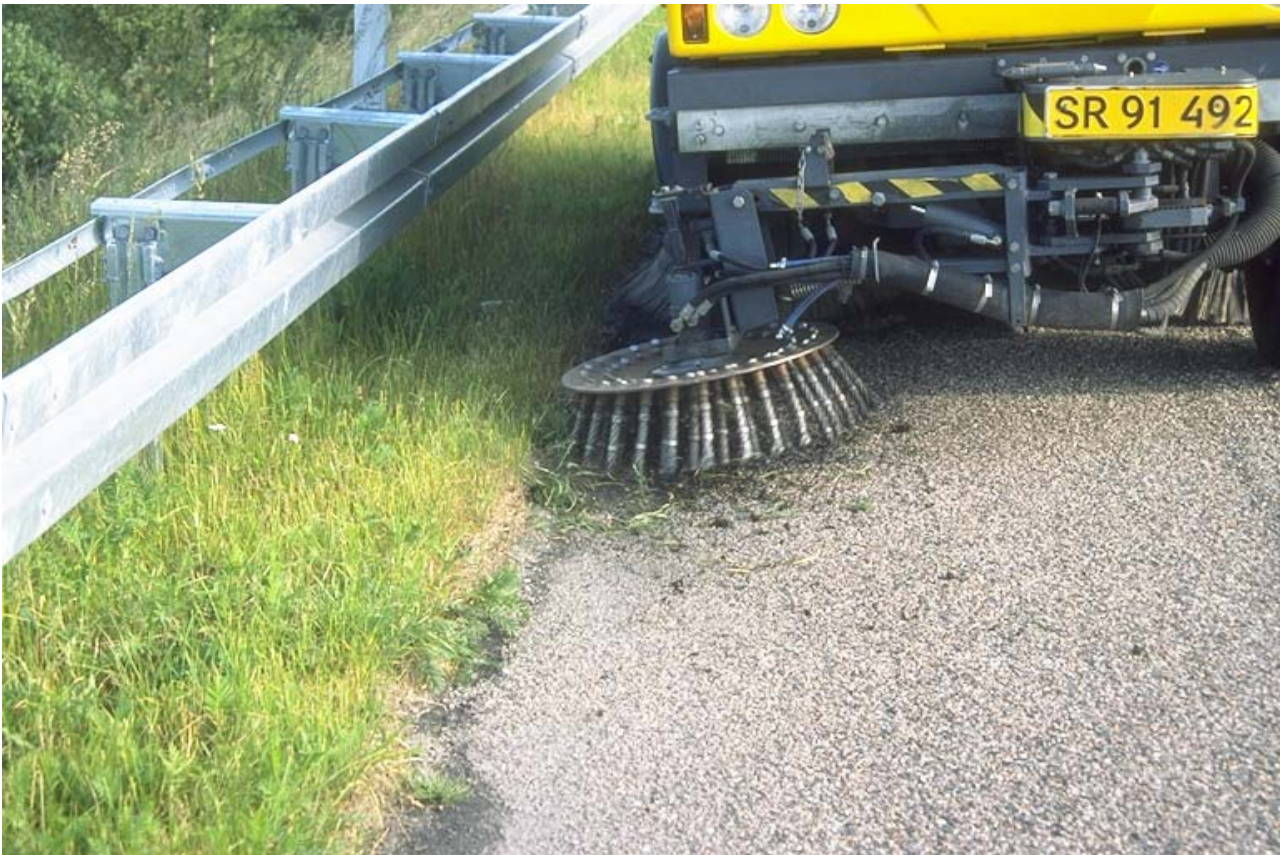
Figur 5. Forud for ukrudtsbehandlingerne er foretaget rengøring med suge-fejemaskine, der kan gøre rent helt ind til vulsten.
