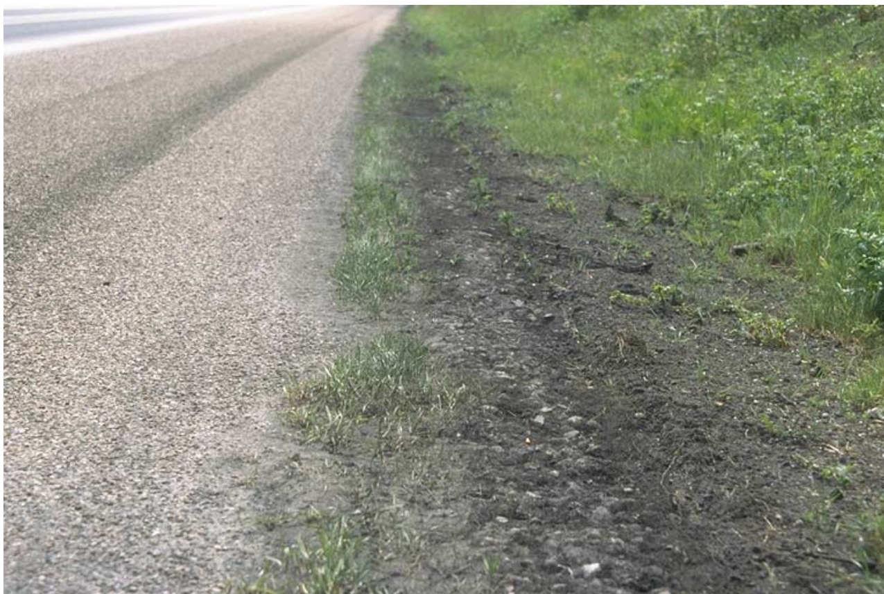
Figur 1. Billedet viser, hvordan der ved udførelse af overfladebelægning ikke er sket fjernelse af den indvoksede rabat eller afrensning af overfladen.
