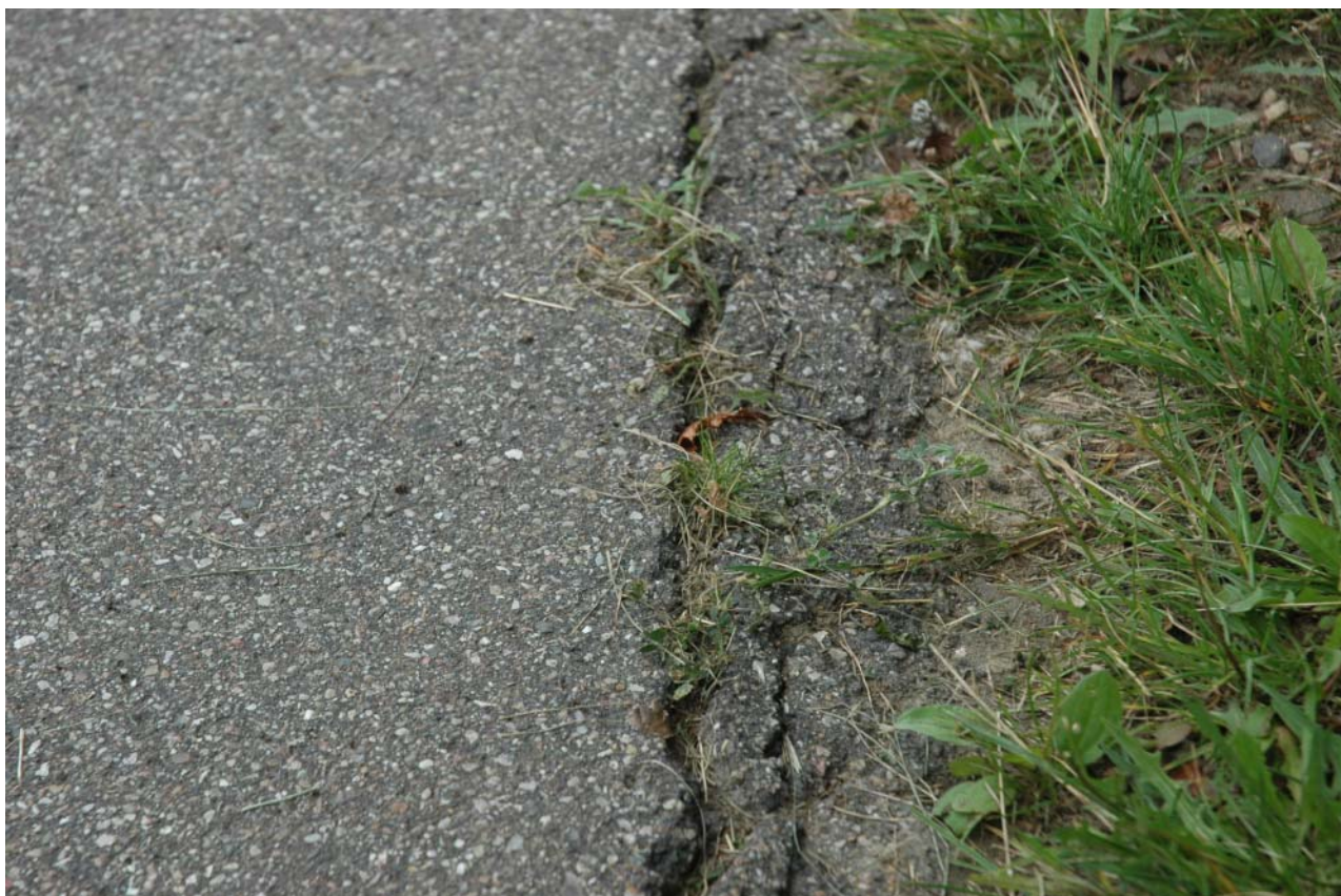
Figur 2. Billede fra 8. juni af en ubehandlet parcel. Væksten i revnen vurderes at forøge nedbrydningshastigheden for belægningen.
