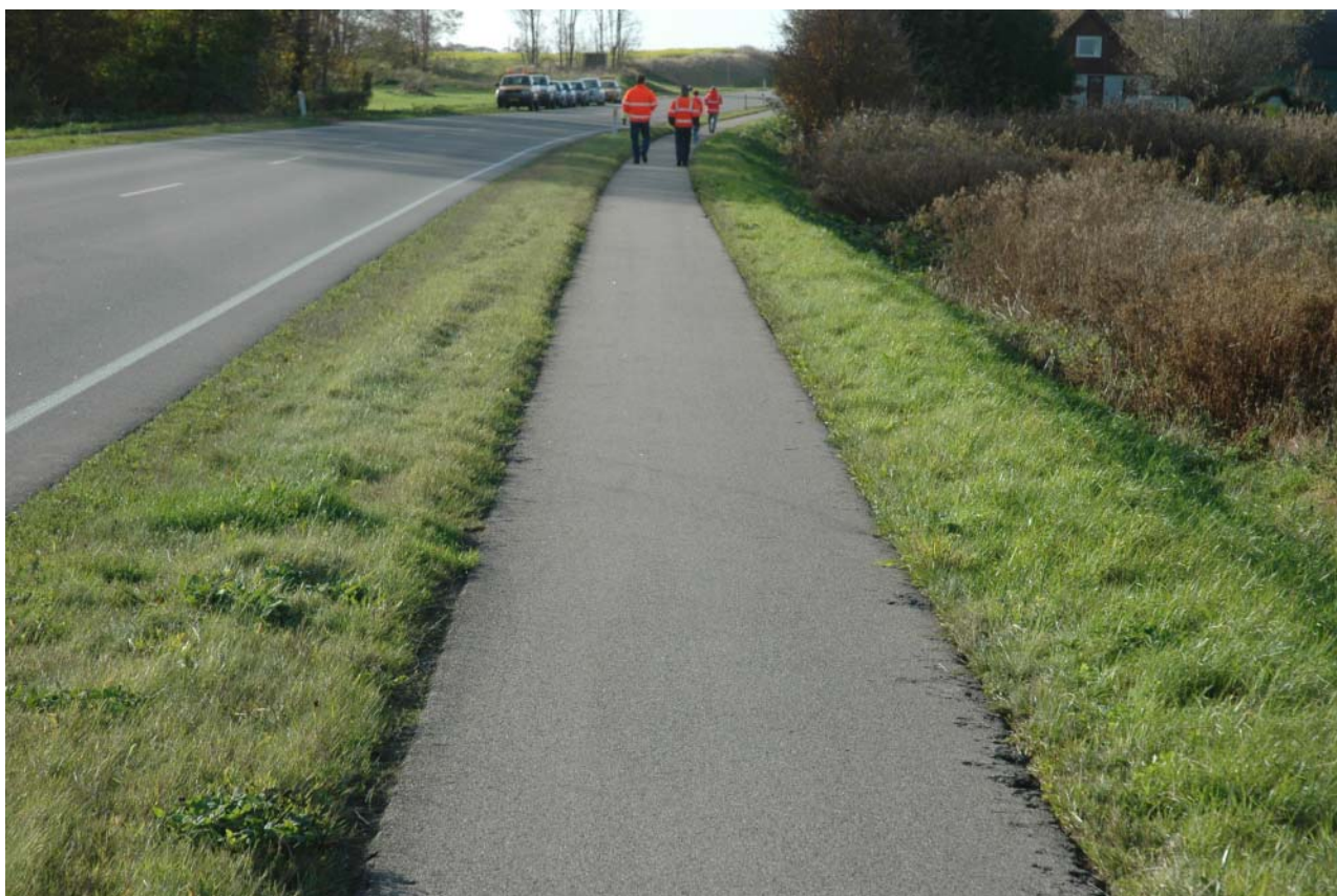
Figur 3. Billede fra 26. oktober fra vej 622 mellem Køng og Lundby af en ubehandlet parcel. Nedbrydningen af asfalten ses bl.a. nederst til højre.
