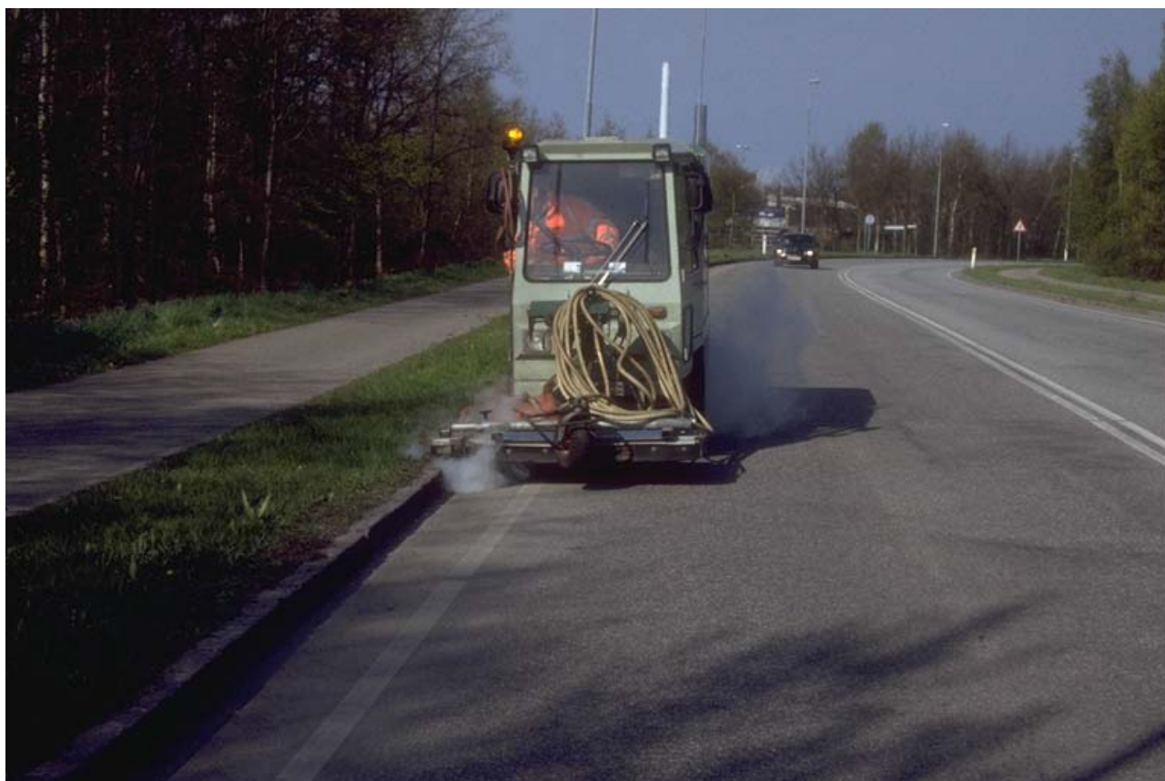
Figur 5. Dampbehandling af kantsten i Kalundborg den 29. april. Behandlingen foregår med kantstensaggregat, der i samme omgang kan behandle oppe og nede på samme tid.
