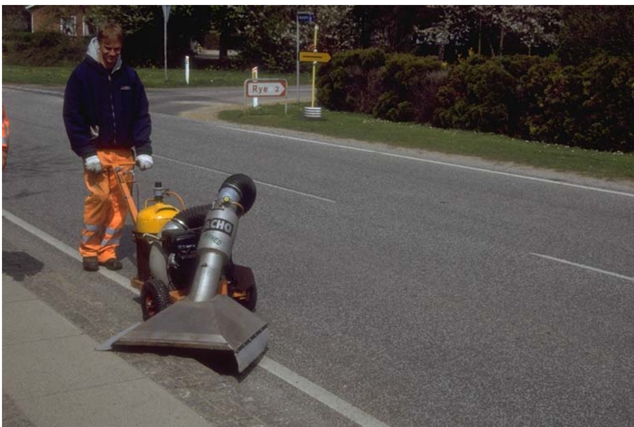
Figur 7. Hedluftbehandling i Kirke Helsingør den 29. april. Den skråtstillede skærm sikrer, at varmen kommer ned i bunden af kantstenen, hvorimod fordelingen på arealet over kantstenen ikke vurderes at være lige så god.
