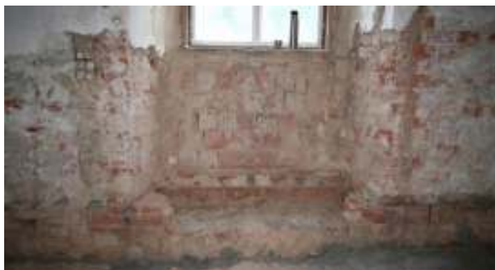
Obrázek 30 Jeseník nad Odrou, zámek, stopa po ztužujícím rámu mezi přízemím a patrem, foto.
