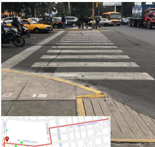
Figura 4.26 Rampas y cruces peatonales incompatibles. Fuente propia
