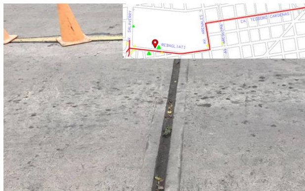
Figura 4.25 Juntas muy anchas sin relleno. Fuente: propia.
