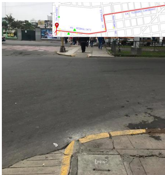
Figura 4.36 Inexistencia de señales horizontales. Fuente propia
