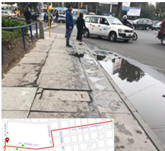
Figura 4.21 Concentración y empozamiento de agua. Fuente: Propia
