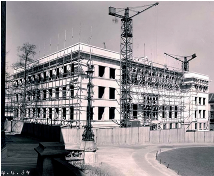
FIGURA 3: Construção do Edifício Eastman, em fotografia de 4 de abril de 1934.– Fonte: Universidade de Rochester.
