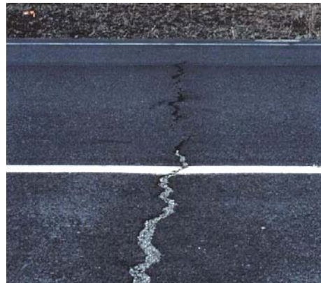
(d) Transverse cracking
