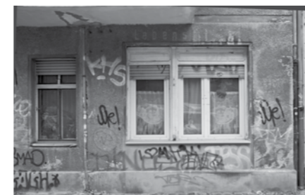
Umbau zur Wohnung, falsche Fensterproportionen
