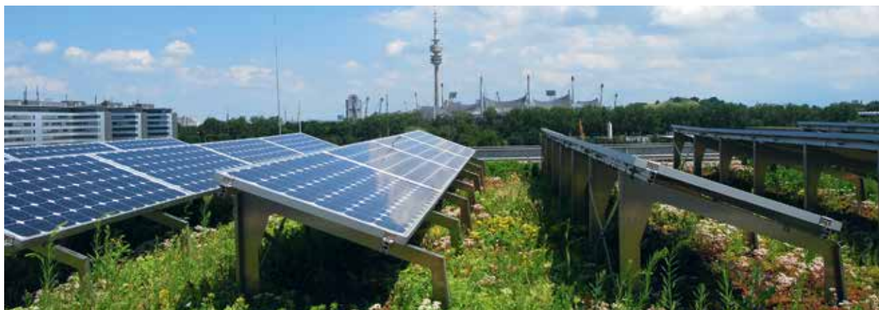
ABBILDUNG 3.2 – 6 ▶ Photovoltaik-Aufdachanlage mit Dachbegrünung, Münchner Technologie Zentrum.
