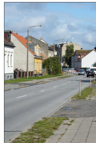
Abb.17: Loitzer Str. mit baulichen Mängeln, fehlender Radweg
