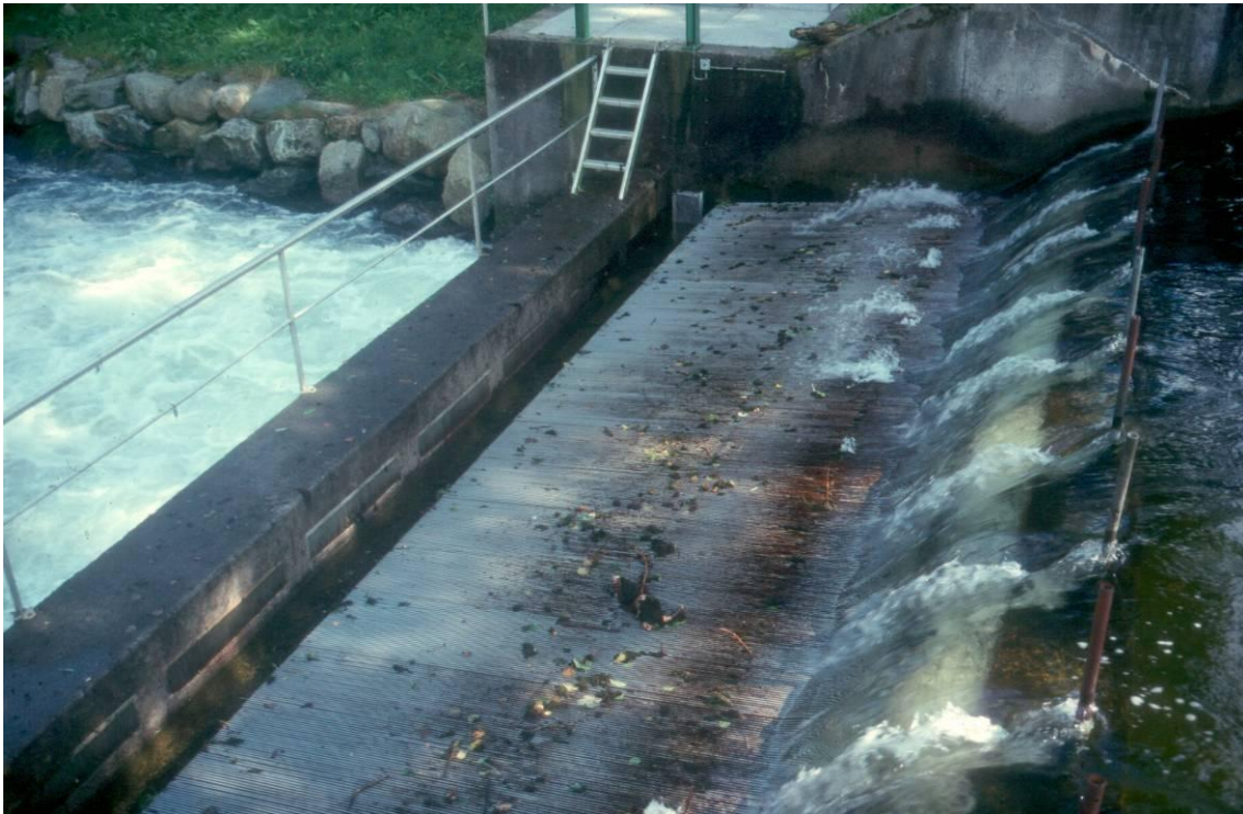
Abb. 5.34: Dieses Tiroler Wehr in der Imsa (Norwegen) wird seit Anfang der 1980er Jahre permanent zur Grundlagenforschung zum Wanderverhalten diadromer Arten eingesetzt
