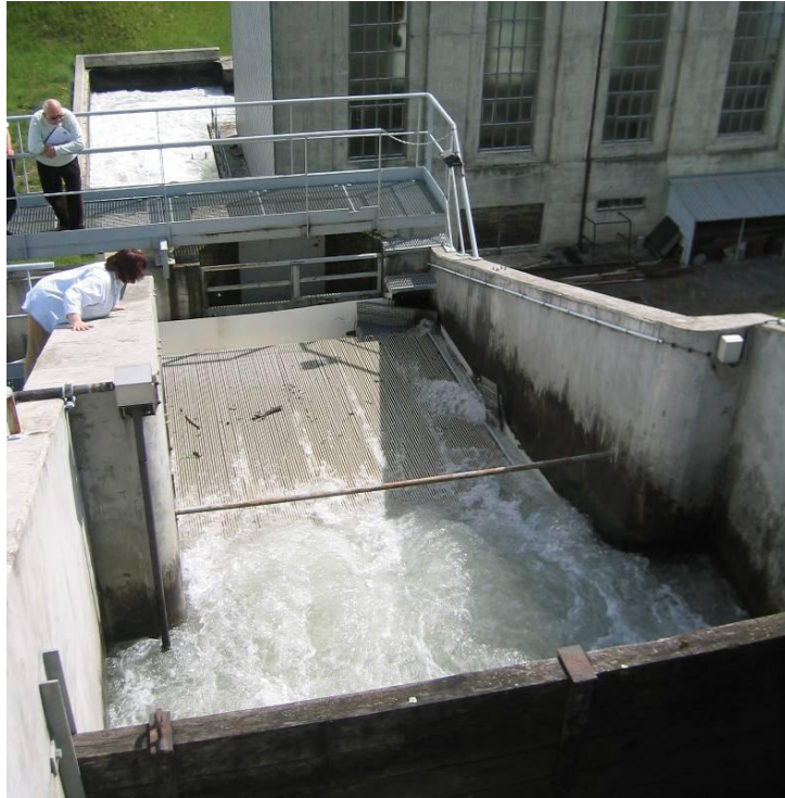
Abb. 5.35: Tiroler Wehr im Lachsby-pass des Wasserkraftwerks Camon im Oberlauf der Garonne (Frankreich)
