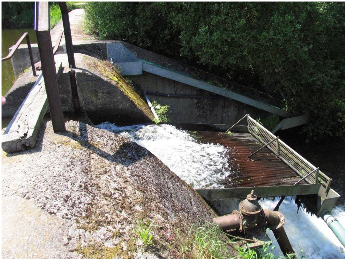
Abb. 5.33: Tiroler Wehr zur Untersuchung der Blankaalabwanderung im Frémur, einem kleinen normannischen Küstenfluss; im Bild rechts unten ist eine Rohrleitung erkennbar, über die die gefangenen Aale in eine Fangkammer gelangen
