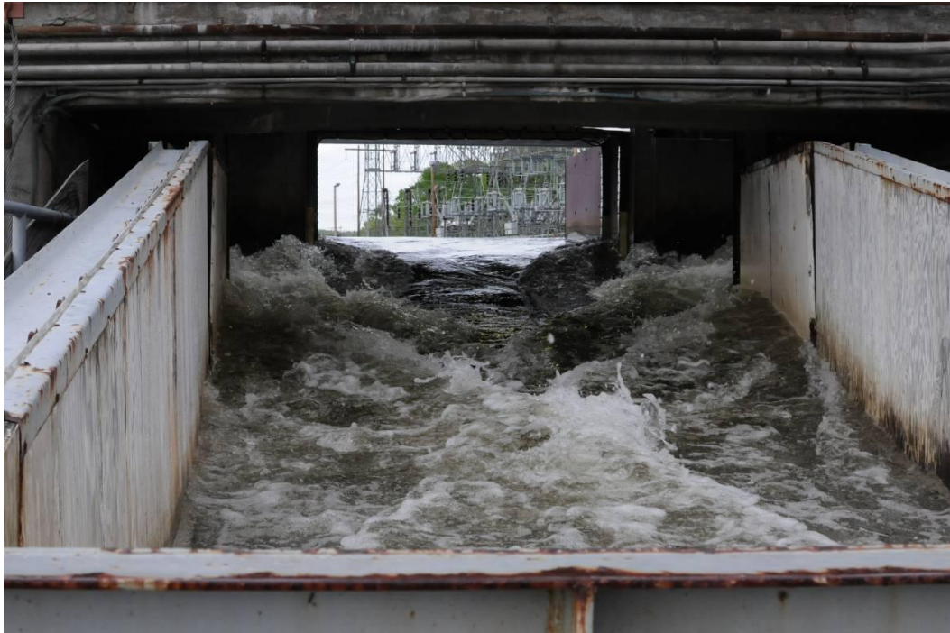
Abb. 5.30: Lachsbypass am Wasserkraftwerk Cabot Station am Connecticut River bei Turners Falls (USA): der Abfluss wird durch eine Klappe im Einlauf reguliert ...
