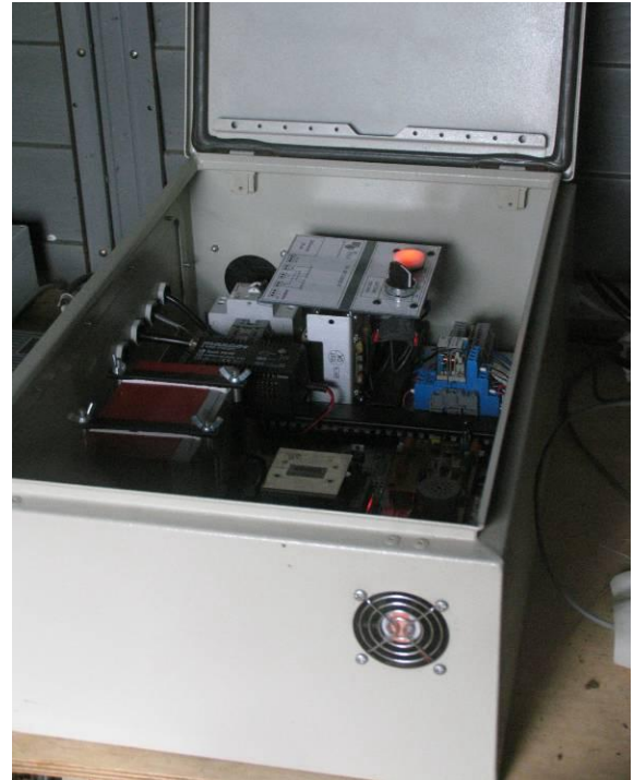
Abb. 5.83: Französischer Schaltkasten für zwei HDX-Lesegeräte und ein Netzteil
