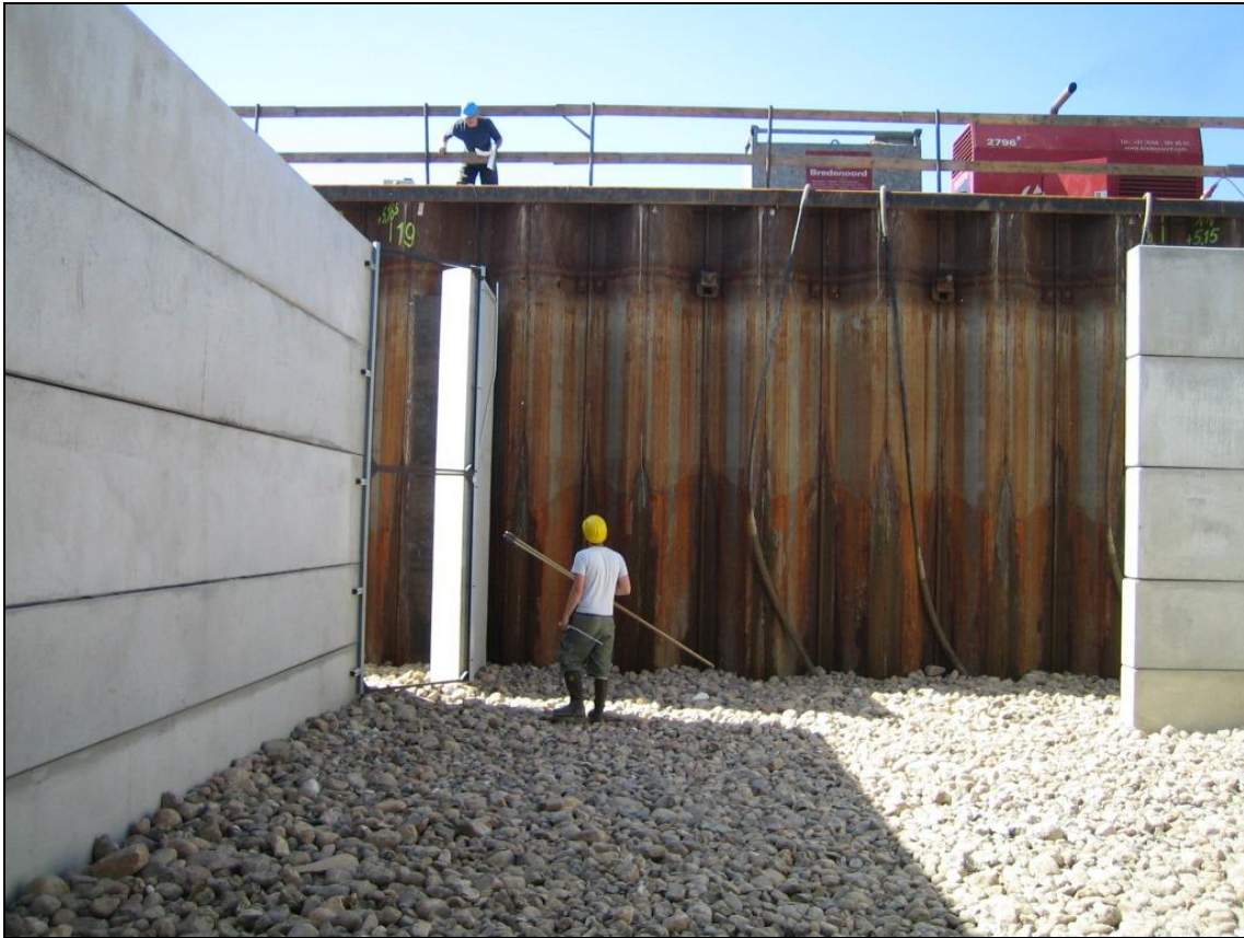
Abb. 5.79: An verschiedenen Positionen im Verlauf des Doppelschlitzpasses am Wehr Geesthacht an der Elbe (Schleswig-Holstein) wurden 18 Rahmenantennen von maximal 5,4 m Höhe und 1,3 m Breite in die Schlitze eingebaut
