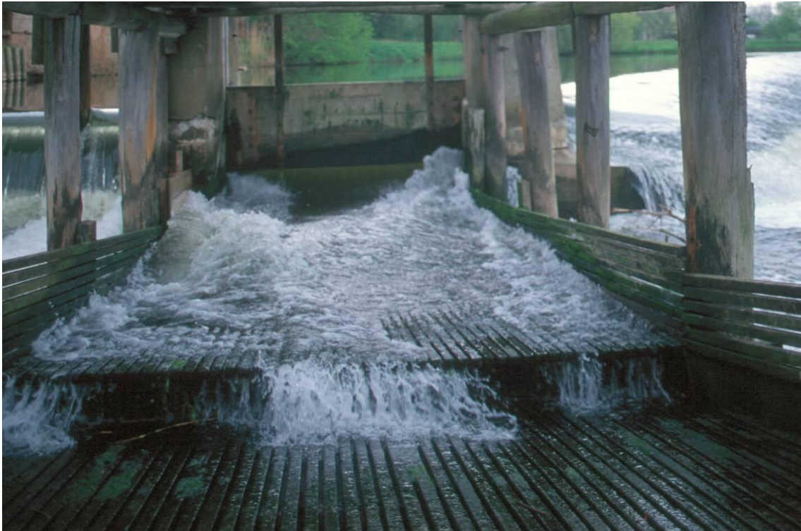
Abb. 5.16: Stationäre Aalfang an der Werra, Blick von Unterwasser auf Auffangrinne, Rechenfläche und Einlaufschütz
