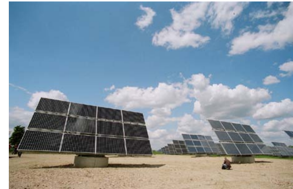
Solkraftwerk Borna auf einer Industriebrache der Braunkohlenveredlung (Sachsen – Mitteldeutschland) Foto: Berkner
