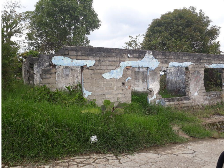
Imagen 1: Ruinas de una vivienda familiar. Caldoño, Cauca. 2017
