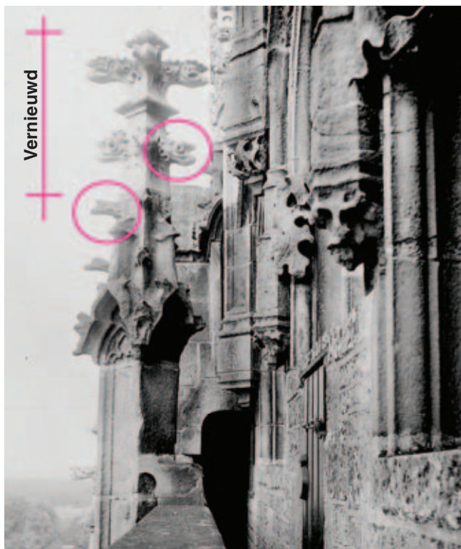
Afb. 5. Omloop noordertransept na de restauratie Frederiks. De middenpinakel heeft een nieuwe beëindiging gekregen (Van der Schaft, ongeveer 1925, RCE, OF-02601)
