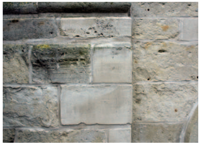
Afb. 17. Mortelreparatie met frijnslag aan de voet van de toren van de Sint Annakerk te Bottelare (België)
