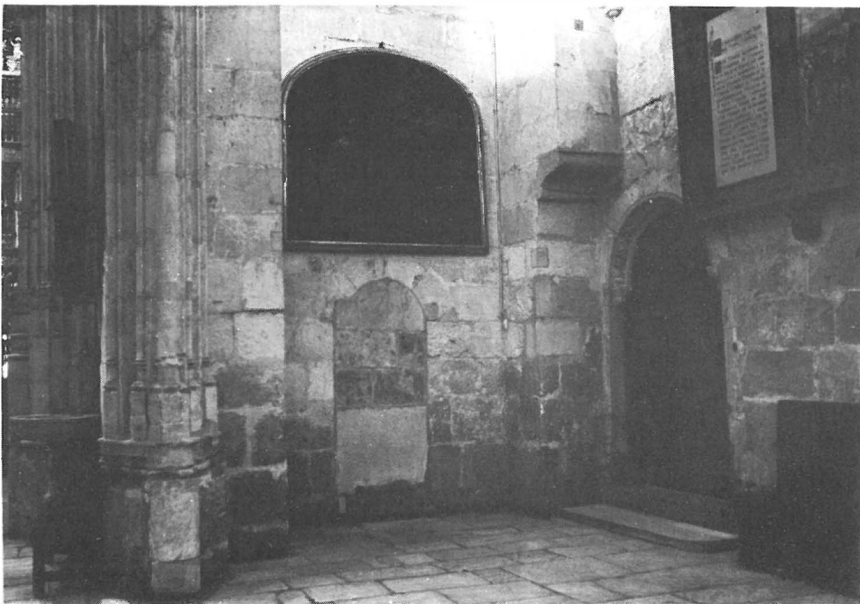
Fig. 13.- Puerta principal de la Capilla Real. El pilar a ha sido cortado y suspendido sobre una ménsula.
