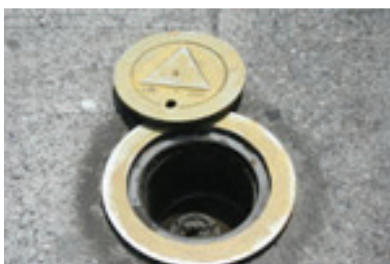
Poço de monitoramento
