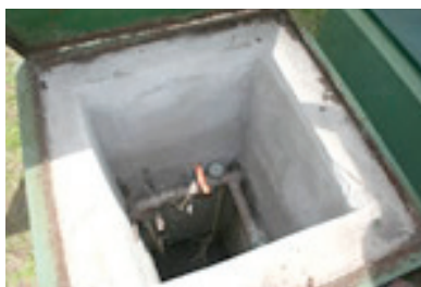
Sistema de extração de vapores
