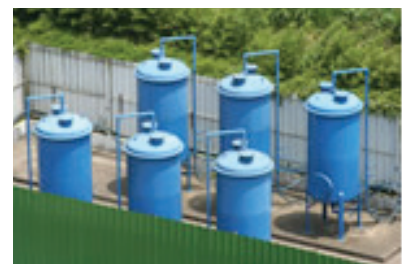
Estação de tratamento de gases
