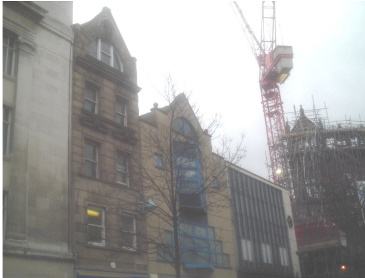
Figura 14: Rua Fargate em 2006. Foi detectada a perda de sua identidade original, com a profusão de novos edifícios. Ao fundo, uma fachada vitoriana inteira é mantida intacta, como uma máscara, enquanto o restante do velho edifício é demolido para dar lugar a novas instalações. Fonte: foto dos autores.
