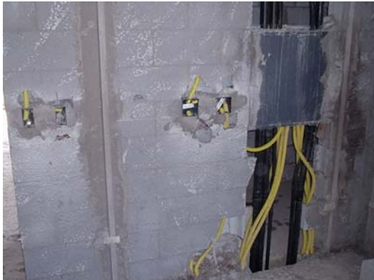
Foto 10: Parede do quadro de elétrica
