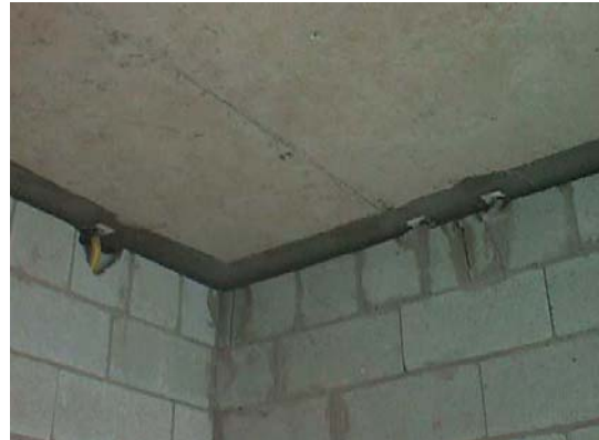
Foto 11: Interface com a tubulação
