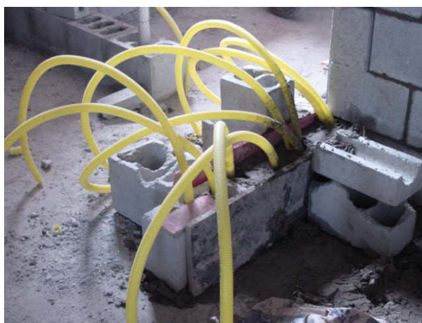
Foto 5: Detalhe da parede do quadro de distribuição – improvisação na obra
