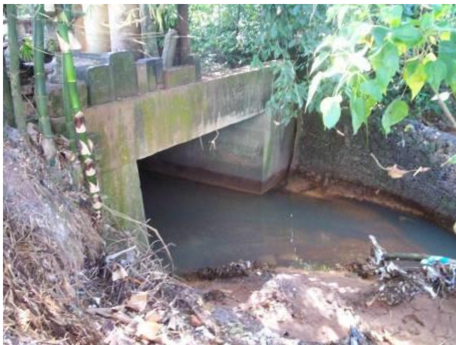
Figura 13: Local onde ocorre o término da canalização do Córrego Lavapés. Destaque para a tonalidade da água e quantidade de sedimentos e resíduos sólidos acumulados (canto inferior direito da foto). Foto: Os autores.
