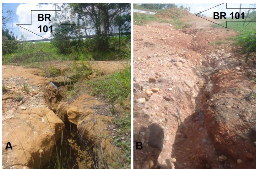
Figura 4 – (A) Formação de ravina sobre os sedimentos mal consolidados (ENb) na cabeceira do rio Santa Cruz (extremo NE da área de estudo), distando apenas 15 m da margem da BR 101; (B) Ocorrência de ravinas sobre a cobertura elúvio-colúvial na margem direita da BR 101, próximas à ponte do rio Mamanguape. Observar, nos cantos superiores de ambas as fotografias, a proximidade com o guard rail da estrada.
