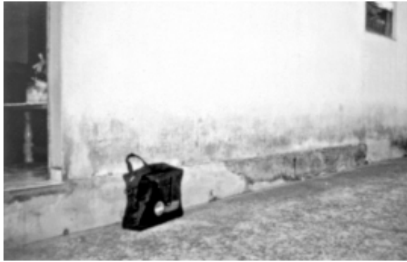
Foto 05 – Habitação em estado original: infiltração de umidade na base das paredes externas e destacamento do reboco Crédito: autor
