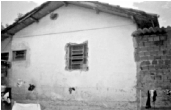
Foto 06 – Habitação ampliada: elevação posterior com destacamento do reboco na base da parede, na parte original Crédito: autor
