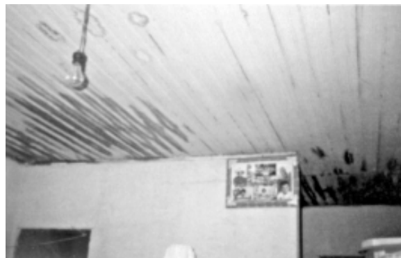
Foto 10 – Habitação ampliada: marcas de infiltrações no forro na parte original, oriundas de infiltrações na cobertura Crédito: autor
