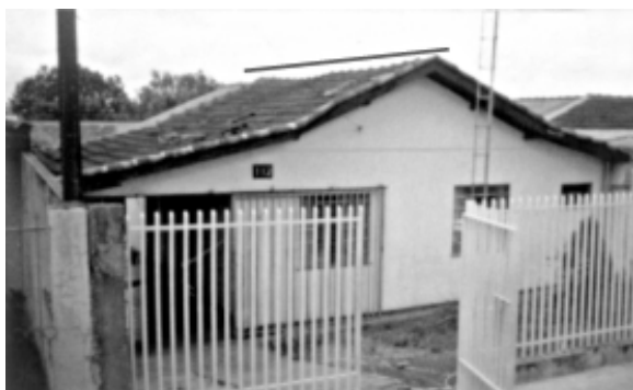
Foto 02 – Habitação ampliada: cobertura em péssimo estado, na parte original Crédito: autor
