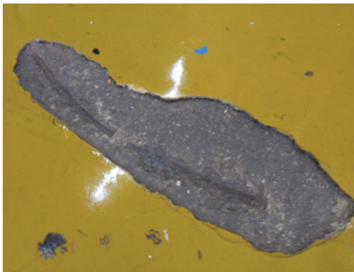
Figura 8: Buraco no piso de epóxi no edifício Vilanova Artigas Crédito: Acervo Conselho Curador
