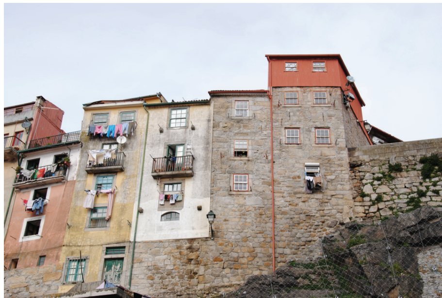
Figura 3: Edifícios de arquitetura corrente no Centro Histórico do Porto, Portugal (intervencionados na década de 1980): diferentes soluções de projeto e de acabamentos; patologias por falta de manutenção. Quais lições podem ser tiradas deste contexto? Foto: Arquivo pessoal, abril de 2010
