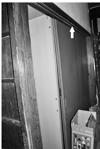
図 65 痕跡⑨：納戸の出入口の敷鴨居に2本溝（矢印）
