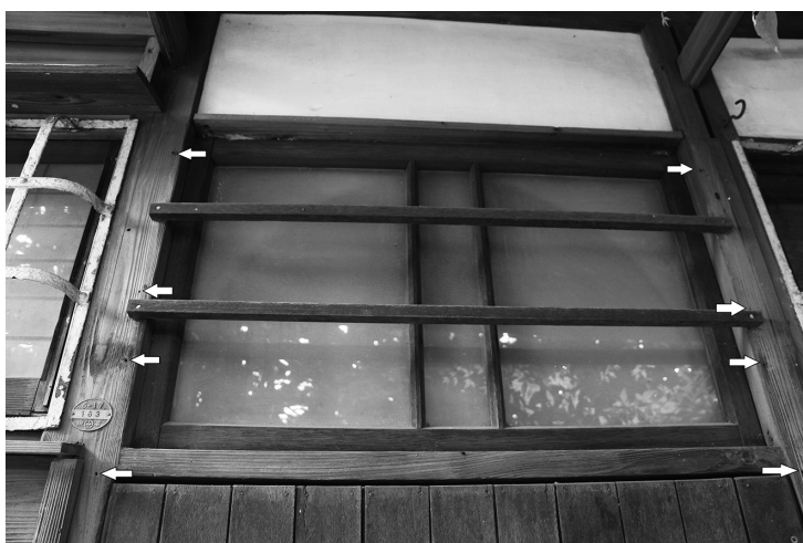
図 62 痕跡⑧：欄間窓両側の柱に、鉄格子を止めた釘穴（矢印）
