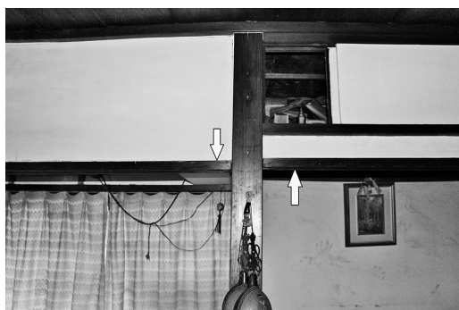
図 67 痕跡⑫：6畳間西側の柱の両面に接合する鴨居の位置がずれている。（矢印）
