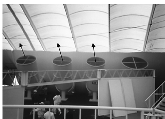
b) エアドーム加圧ファンの吹出口 (吹出口は右側の F1~F3, 左端の F4 (予備・停止) に対応) ファンの容量は、F1~F3 全開 1 時間でブローアップができる容量
