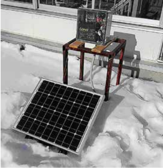
図6 太陽光パネルによる自立型遠隔監視システム
