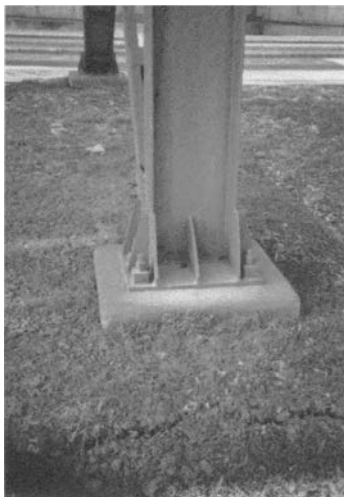
写真-3 コンベアの柱の周りの状況
