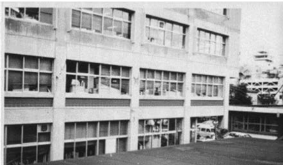
写真-2.1 八戸市役所別館の柱の亀裂
