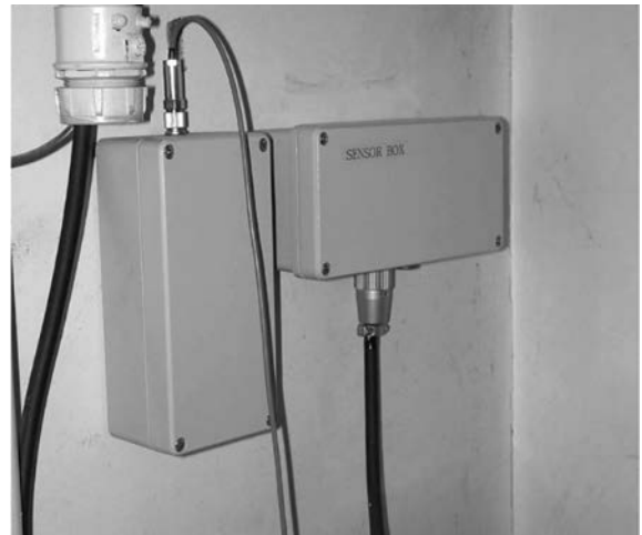
写真-4.1 改造後の広帯域地震計
