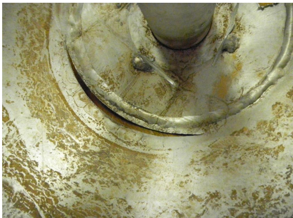
Рис. 8. Общий вид места разрушения внутри
