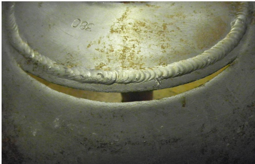
Рис. 7. Общий вид места разрушения снаружи
