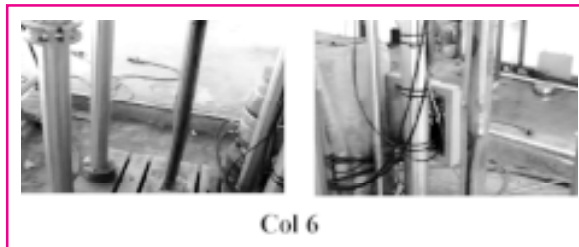
Figura 18. Falla por pandeo global y local de la columna tipo abierta 6.
