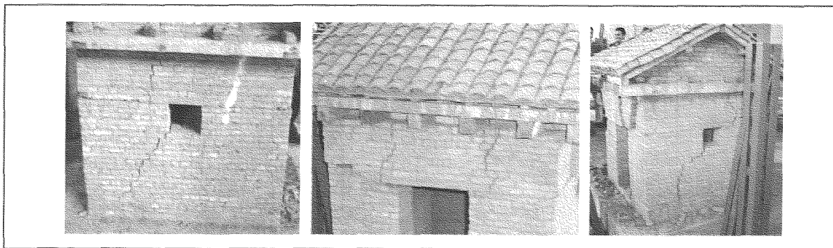
Figura 6. Detalle de grietas - Vivienda I
