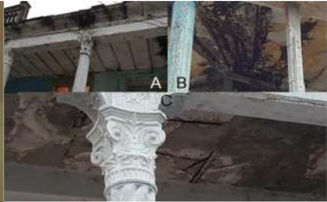
Fig. 7 Ejemplo de patologías de los materiales en los portales. Fuente: Tomada por los autores
