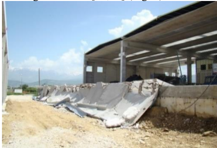
Fig. 1. L'Aquila 2009: struct OK, panelsKO.
